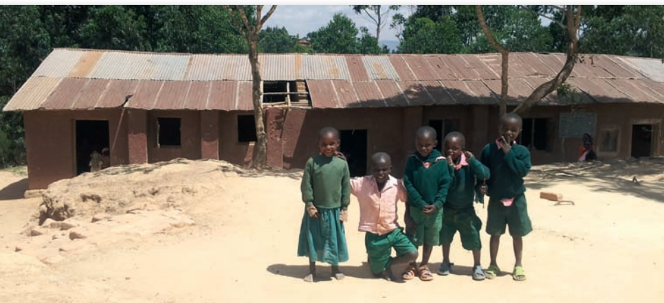
Es fehlt an Klassenräumen und das bestehende Gebäude muss renoviert werden.
